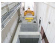
8 灰渣贮坑 & 灰渣起重机操作室
